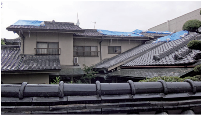
大阪府北部地震による屋根の被害 写真提供:(一財)消防防災科学センター(災害写真データベース)
